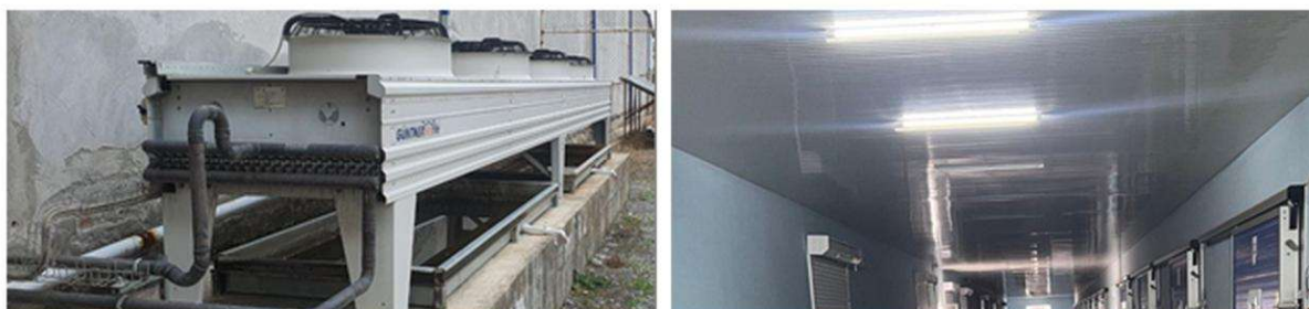
Рис. 5. Элементы технологии охлаждения: воздухоохладитель и внутренний объём холодильного коридора.
